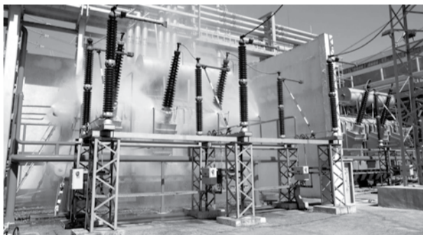
Изпитания на системата за пожарогасене на резервни трансформатори на 5 блок.
